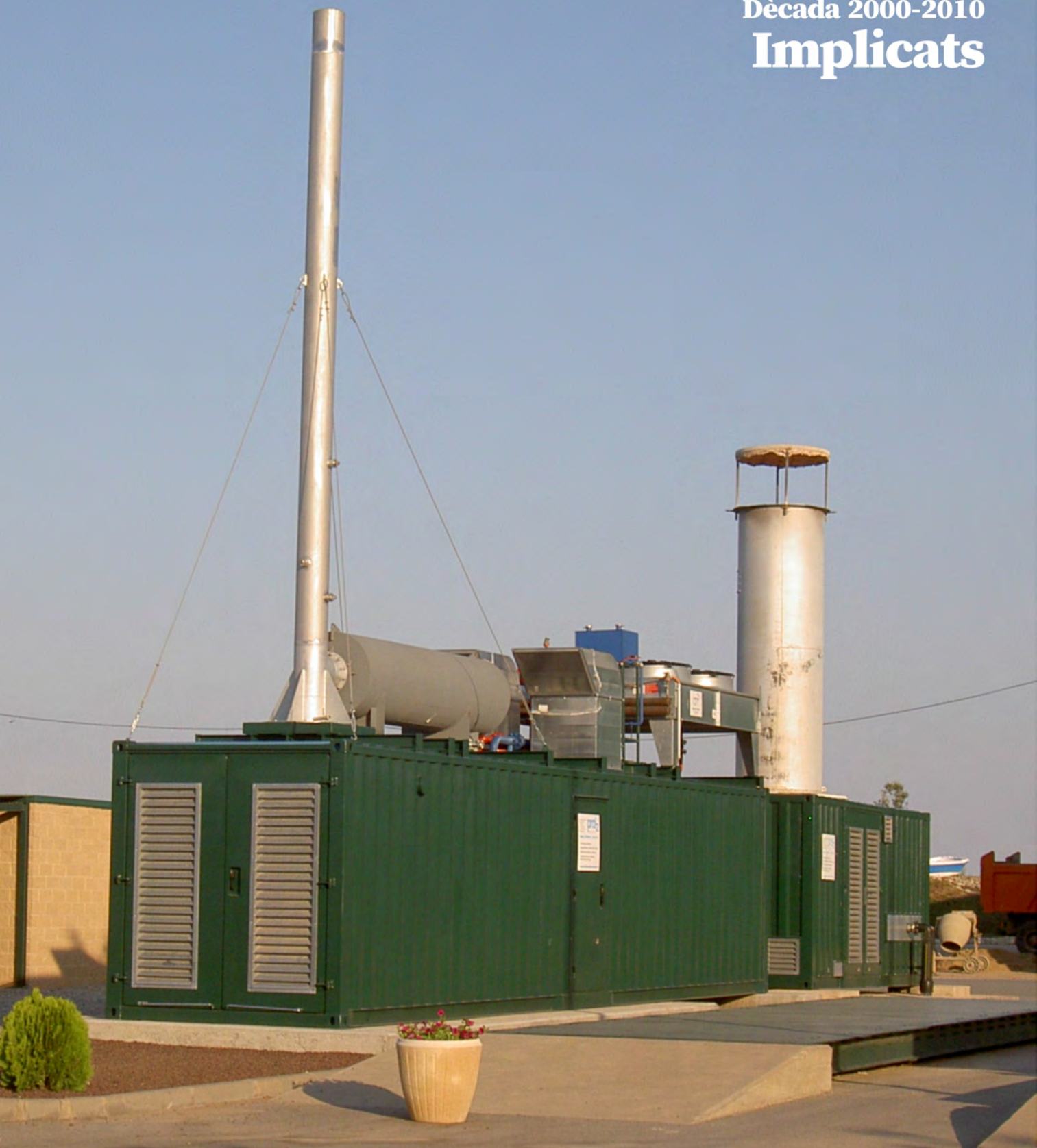
Torxa i motor de cogeneració elèctrica
