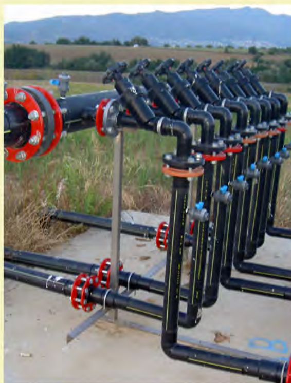
Extracció de biogàs
