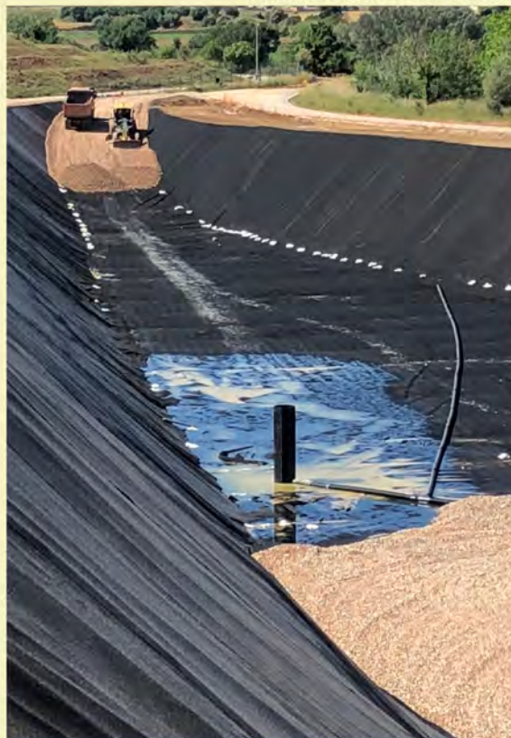
Bomba d'extracció de lixiviats
